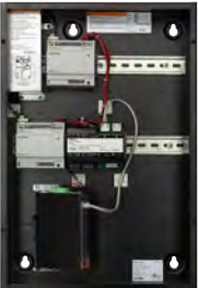
Procesador y módulos de control
